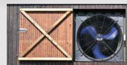
Der Ventilator wird, wenn möglich, in die Außenwand des Stalls eingebaut oder durch einen angrenzenden Raum mit ausreichend Luftvolumen mit der Außenwelt verbunden. Dieser ist mit dem Tube verbunden und versorgt den Stall mit Frischluft. 24 Stunden am Tag, an 365 Tagen im Jahr.
