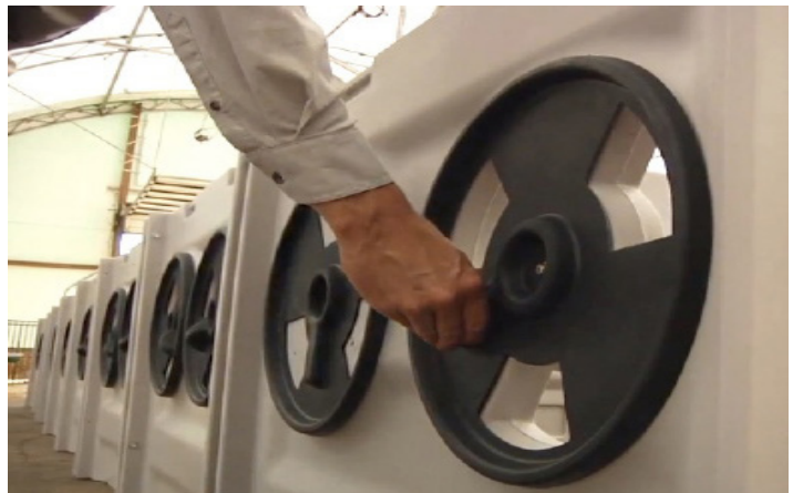
Hinterwand Kälberbox mit Drehlüftung
